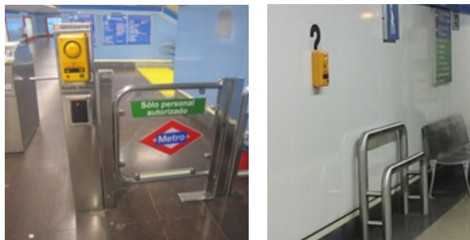
Interfonos de comunicación en vestíbulo y andenes
