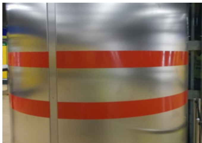
Señalización obstáculos mediante bandas de vinilo rojo
